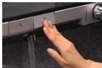
カウンターに埋め込んだタッチ水栓
